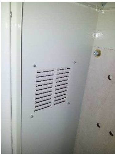
Grille de Ventilation latérale naturelle
